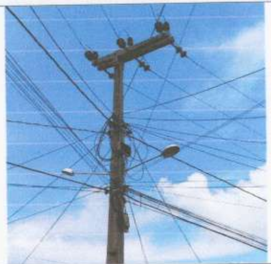
Foto 2 - Poste, braço e luminária
