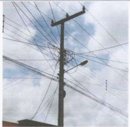
Foto 2 – Poste, braço e luminária
