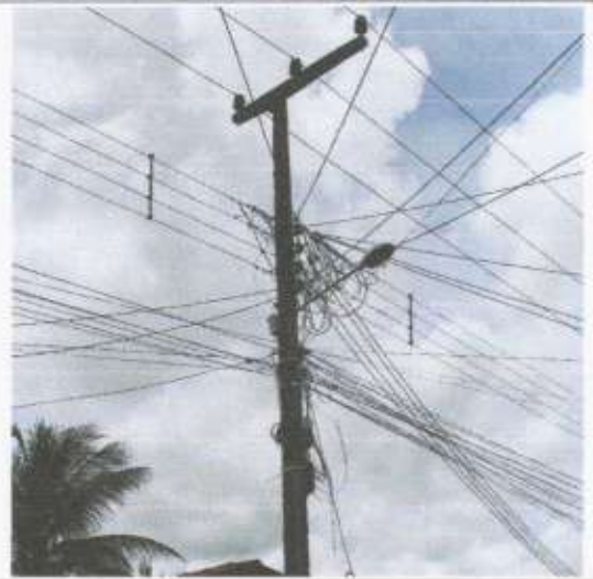
Foto 2 - Poste, braço e luminária
