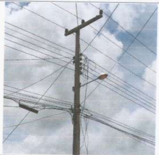
Foto 2 - Poste, braço e luminária
